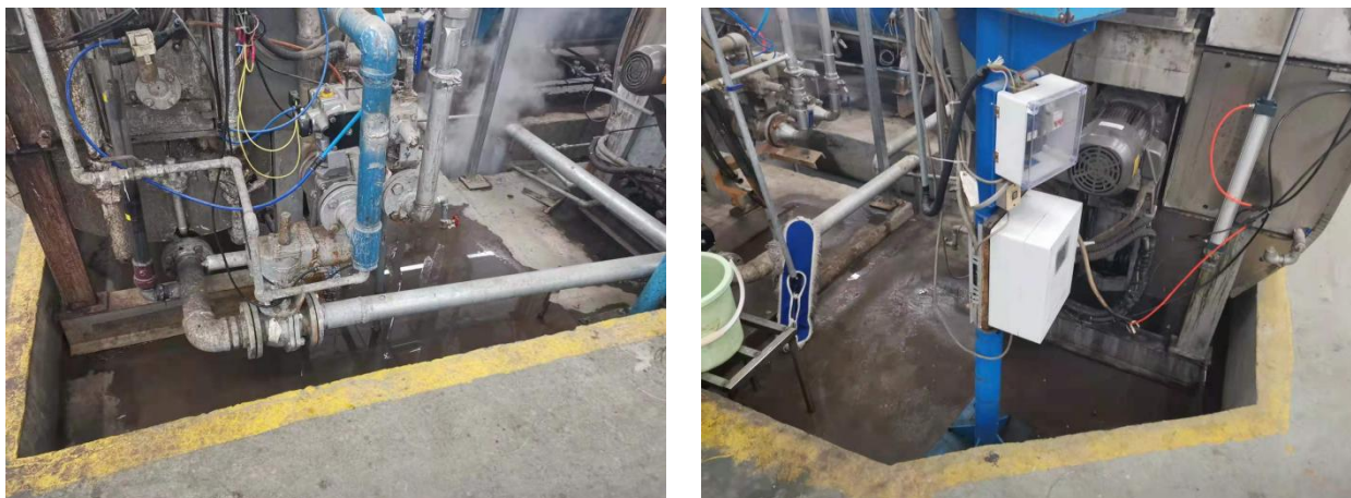
废水管道及收集池
