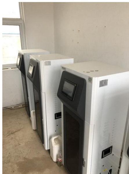
废水在线监测设施
